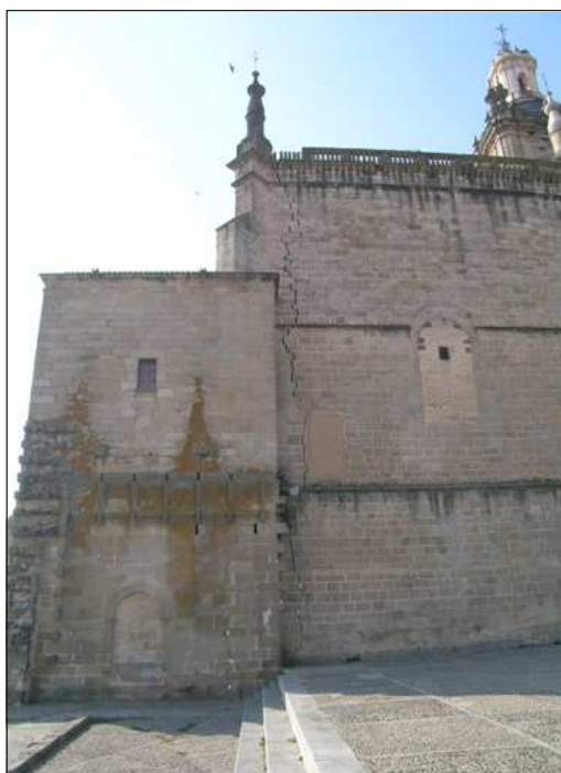
Fig. 11. Grietas en la Catedral de Coria (Cáceres), con posible origen en el terremoto de Lisboa de 1755.
