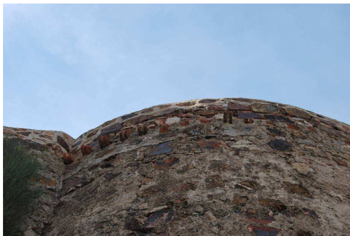
Figura 9: Castillo de Feria, restos del matacán corrido de ladrillos de la torre situada en el extremo del muro divisorio.
