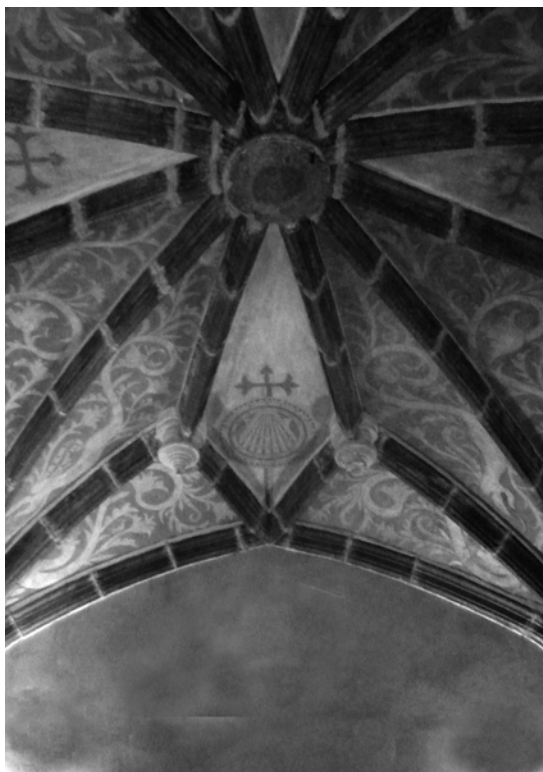
Un detalle de las bóvedas del conventual: nervaduras góticas enmarcando bellos esgrafiados renacentistas. La reciente restauración ha puesto el acento en la recuperación de unas y otros.
