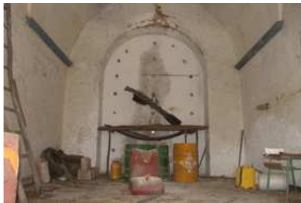
Figura 10. Estado actual del interior de la primitiva ermita de San Isidro de Monesterio, construida en 1951.
