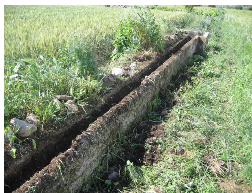
Fig. 16: Acequia de riego
