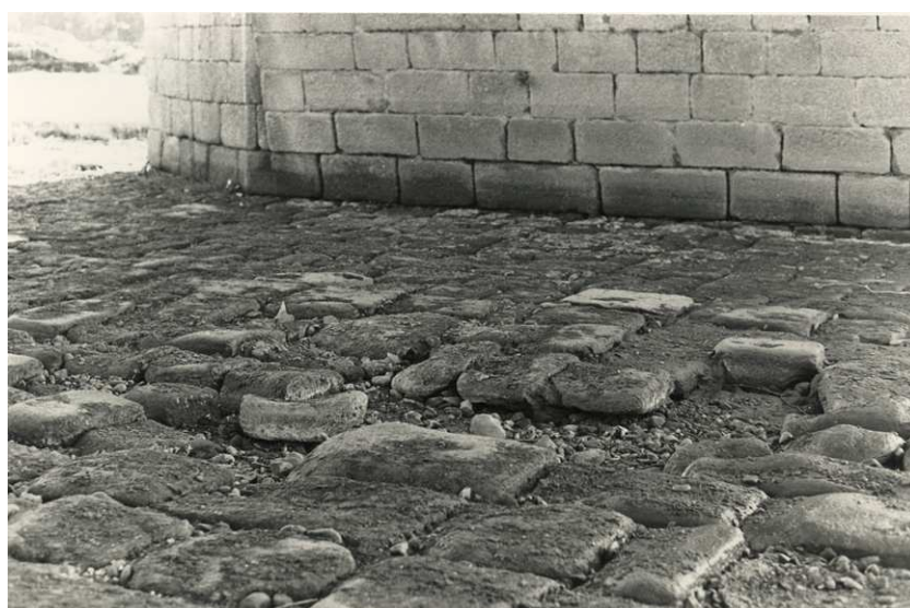
Fig. 2. La losa de cimentación de los nuevos arcos del Puente. Archivo MNAR (Foto M. de la Barrera).
