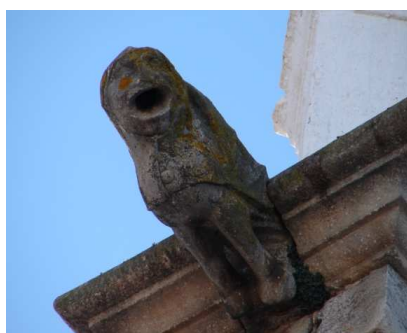
Fig. 15. Gárgola esquina N. Capilla mayor
