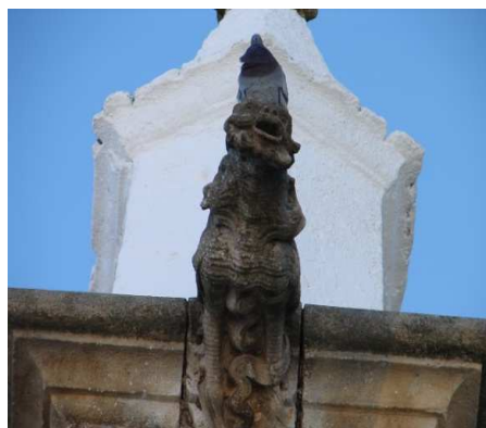
Fig. 22. Gárgola del estribo de la esquina NO
