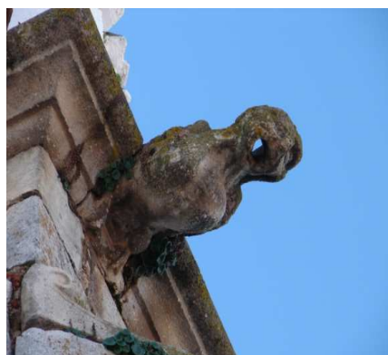
Fig. 17. Gárgola estribo 1. Lado norte.
