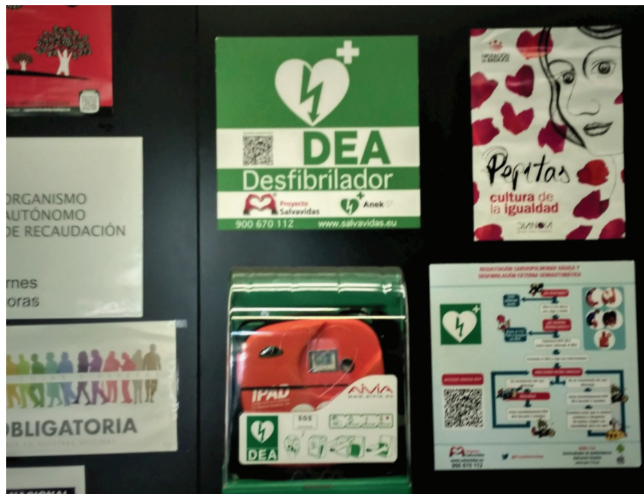
Desfibrilador Externo Automático (DEA) situado en el edificio CID OLIVENZA de la Excm. Diputación de Badajoz en la localidad de Olivenza.
